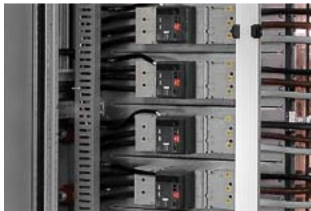
Niederspannungs-Schaltanlage SAS 2000 mit Leistungsschaltern (Motorantrieb) mit vierstufiger Abschaltmöglichkeit 0 / 30 / 60 / 100 Prozent
