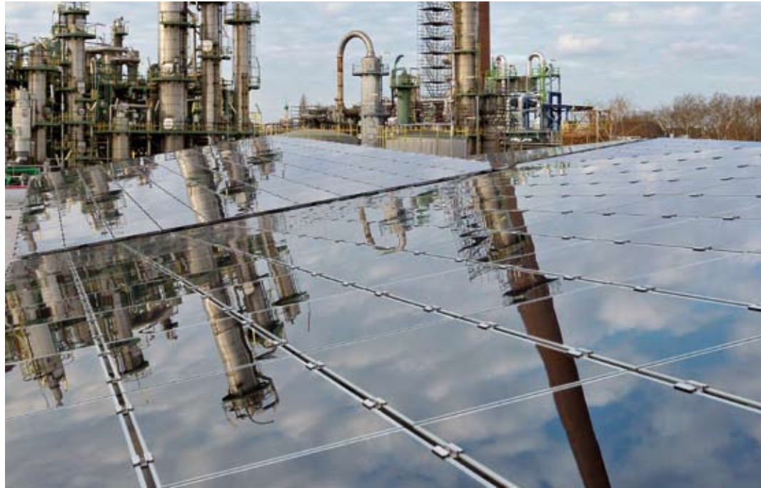
Auf einer Dachfläche von 120 x 60 m wurden insgesamt 4.050 Solarmodule mit einer Gesamtleistung von rund 300 kWp aufgestellt.
